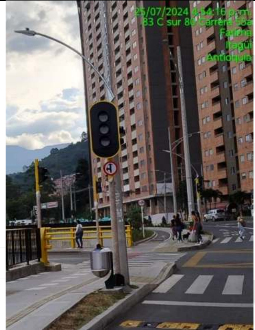
Instalación del cruce semafórico de la Calle 55 con carrera 53A Reservas del Parque
