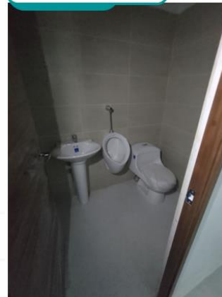
BAÑOS DE HOMBRES
