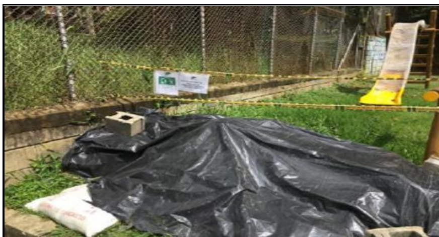
Escombros tapados con plástico y señalizados. El tablado Fuente: ADELI
