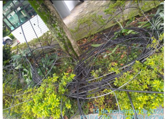
Fibra óptica vandalizada
