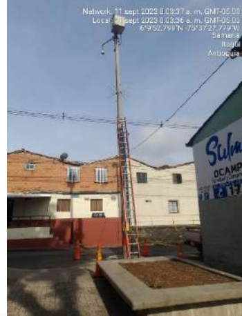
Cámara 42 CANCHA SAMARIA
