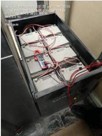
Mantenimiento a UPS del CCM
