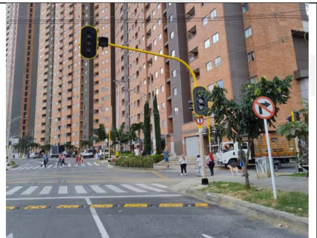
Instalación del cruce semafórico de la Calle 55 con carrera 53A Reservas del Parque
