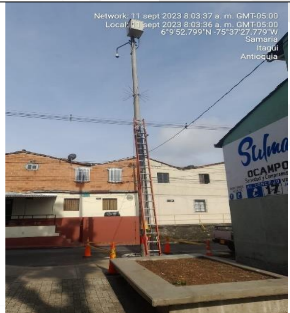
Cámara 42 cancha Samaria
