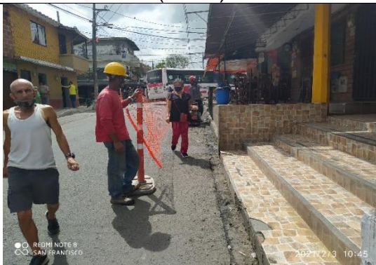
Mejoramiento de andenes San Francisco (antes)
